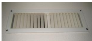
Udsugningsrist i væg og loft
